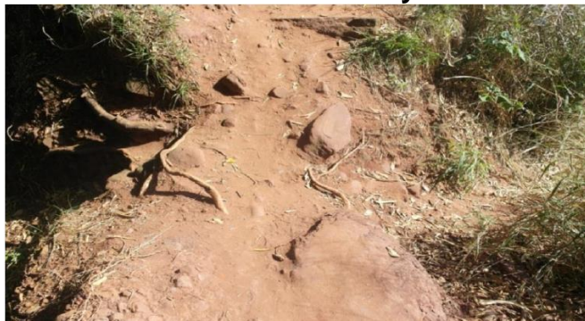
FIGURA 4: Erosión del suelo y las raíces expuestas em estación BM2
