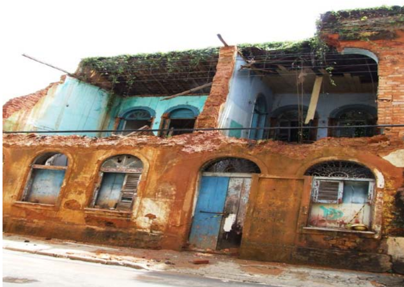
FIGURA 2: CASARÃO EM RUÍNA
